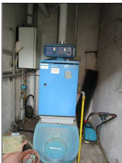
Locale caldaia comune
